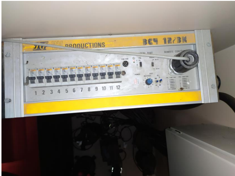
Gradateur 12 x 3kW (socapex) situé en régie
